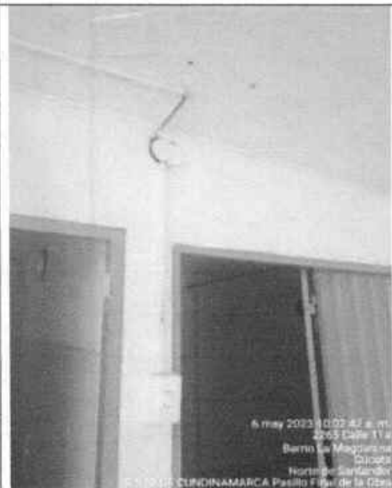
Imagen 16 Salidas de iluminación Cundinamarca
