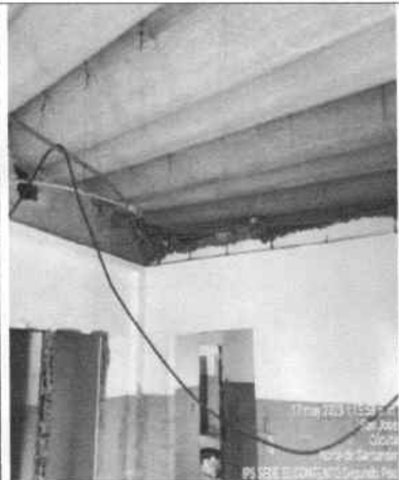
Imagen 10 Acometidas y alimentadores Contento
