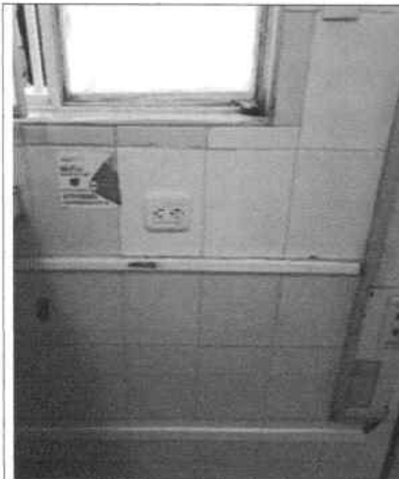
Imagen 21 Salidas de tomas por canaletas Bocono
