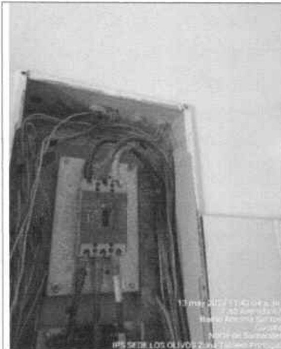
Imagen 5 Tableros de distribución Ips Los olivos
