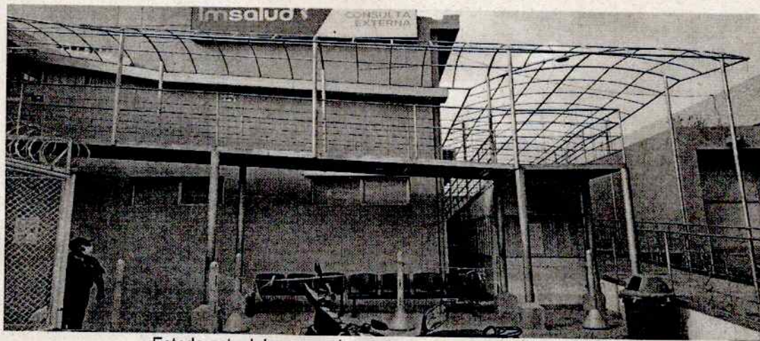
Estado actual de rampa de comuneros, estructura sin cubierta.
