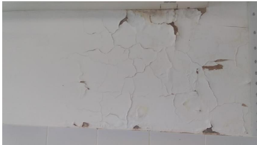
Ilustración 4 Humedades en consultorio pyp IPS BANCO DE ARENA
