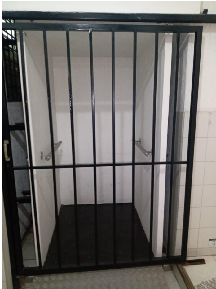
Ilustración 12: Ascensor El Contenido
