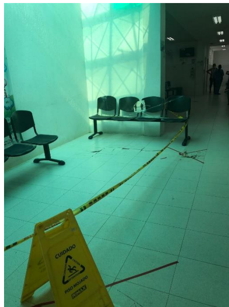
Ilustración 3. Tandem inestable, silla desprendida
