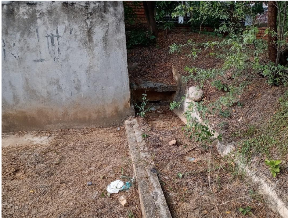
Figura 25. Canal área externa trasera totalmente tapado por tierra y escombros
