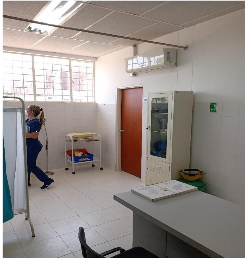
Figura 12. Consultorio médico 2 – ventanas en hierro oxidadas
