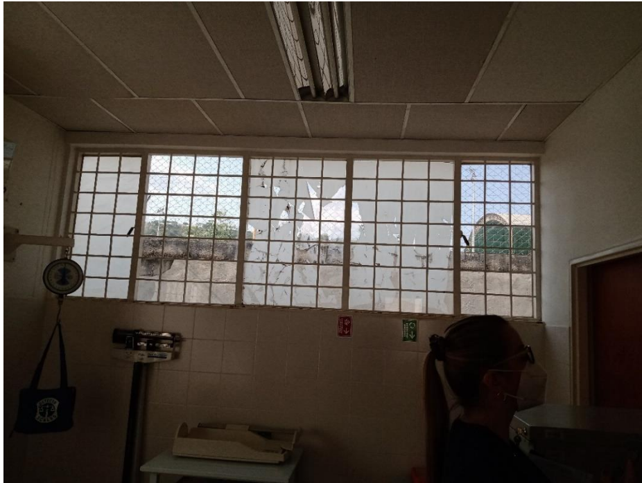
Figura 9. Ventana con reja de hierro consultorio PYP
