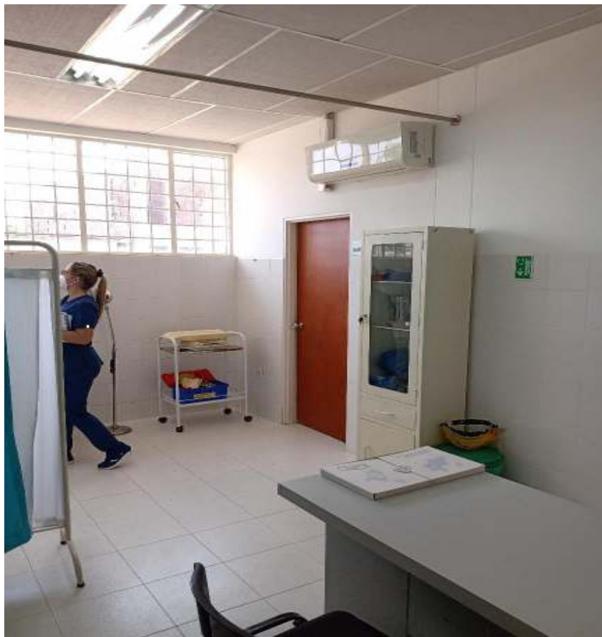
Figura 12. Consultorio médico 2 – ventanas en hierro oxidadas
