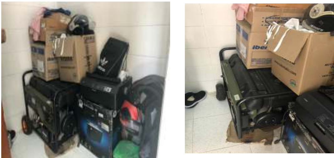
Figure 5 AREA DE EQUIPOS DE BAJA
