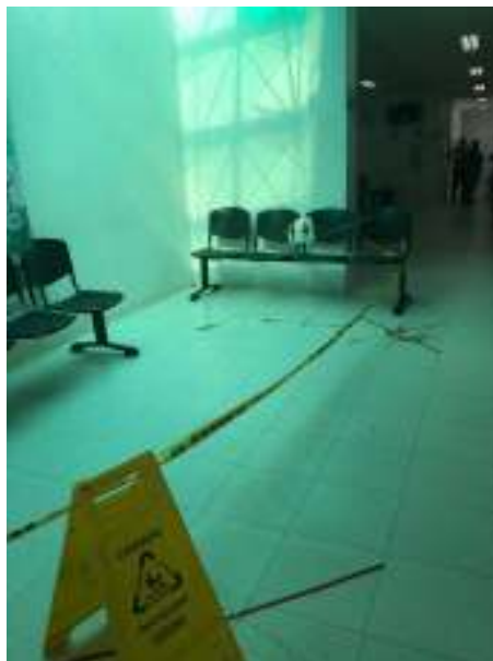
Ilustración 3. Tandem inestable, silla desprendida
