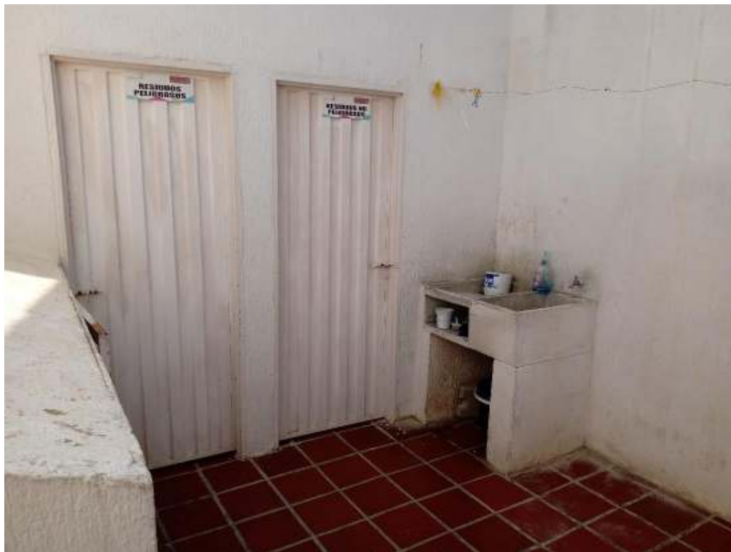
Figura 18. Área de residuos
