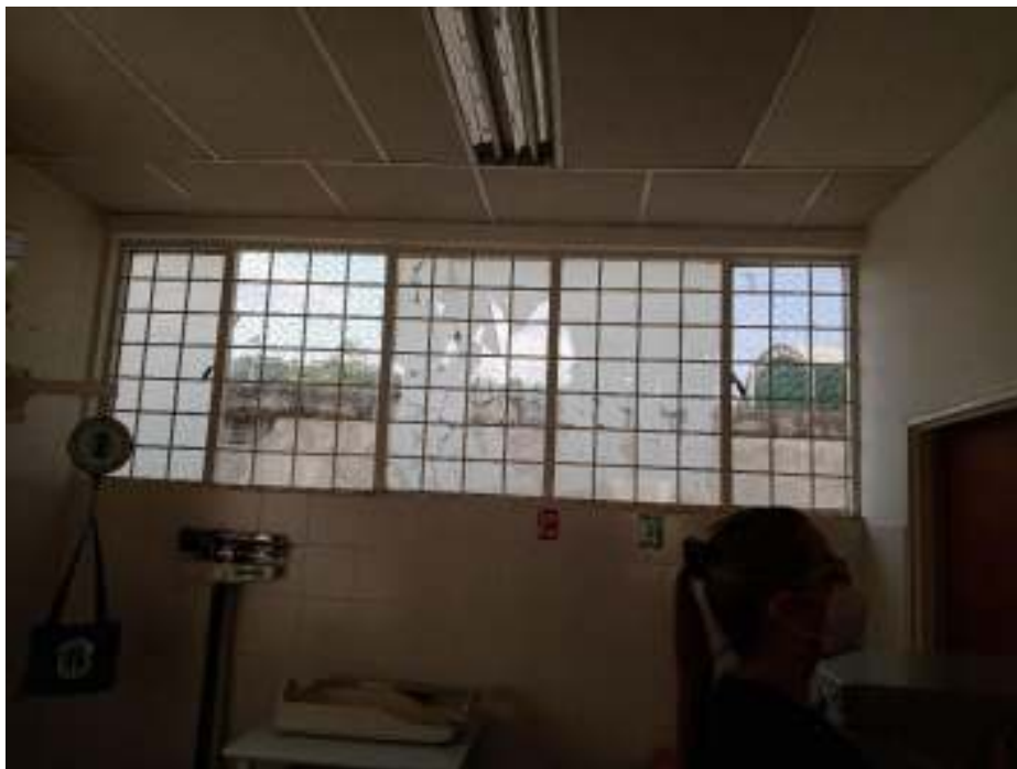
Figura 9. Ventana con reja de hierro consultorio PYP
